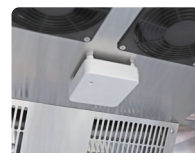
冷蔵庫 庫内の子機設置例
